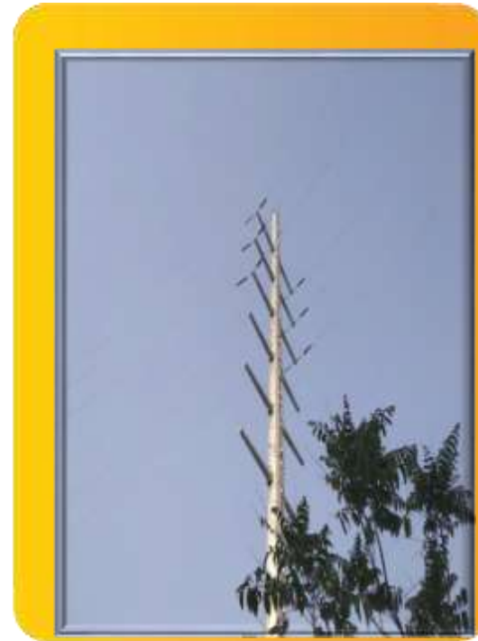
220 kV M/C pole UPPTCL
