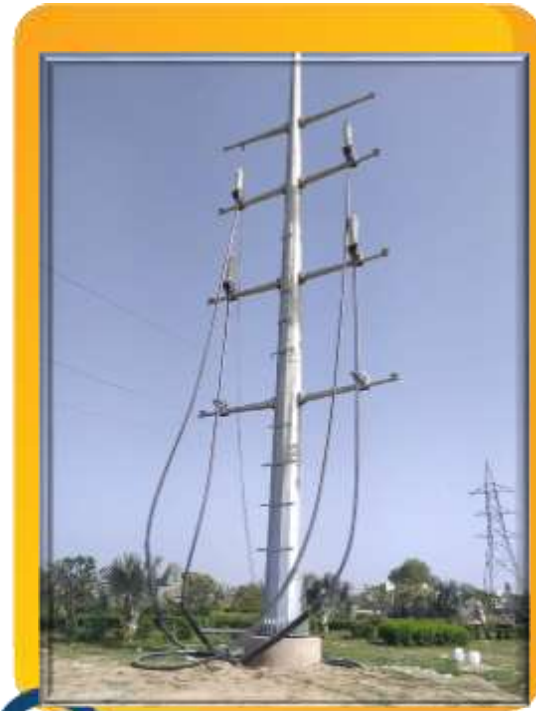
132 kV D/C CT Pole - HVPNL
